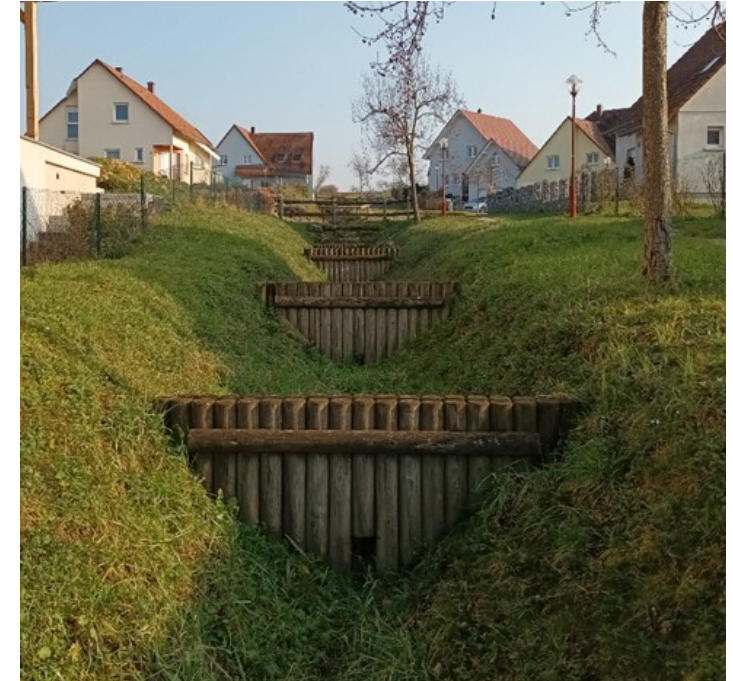
Noue d'infiltration et limiteur de débit d'eau Quartier Steinberg, Niedermodern Source : ATIP
